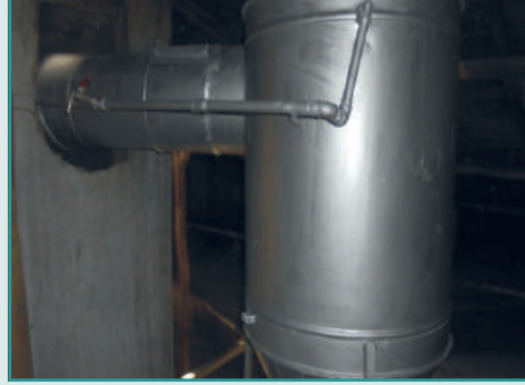
Filtre Sisteminin Ait Pide Fırınının Sonraki Durumu
