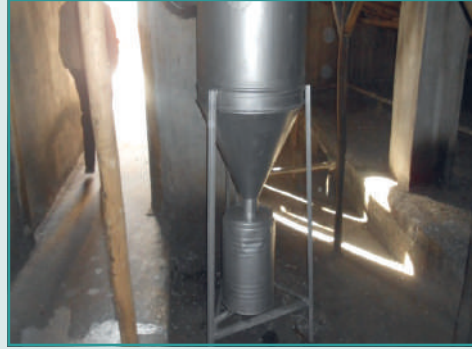
Filtre Sisteminin Ait Pide Fırınının Sonraki Durumu
