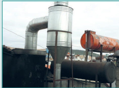
Filtre Sistemi ve Baca Yüksekliğine Ait Pide Fırınının Sonraki Durumu
