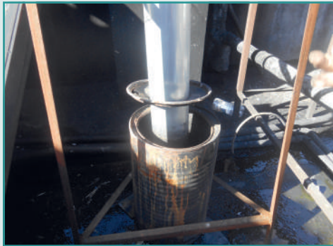
Filtre Sistemi ve Baca Yüksekliğine Ait Pide Fırınının Önceki Durumu
