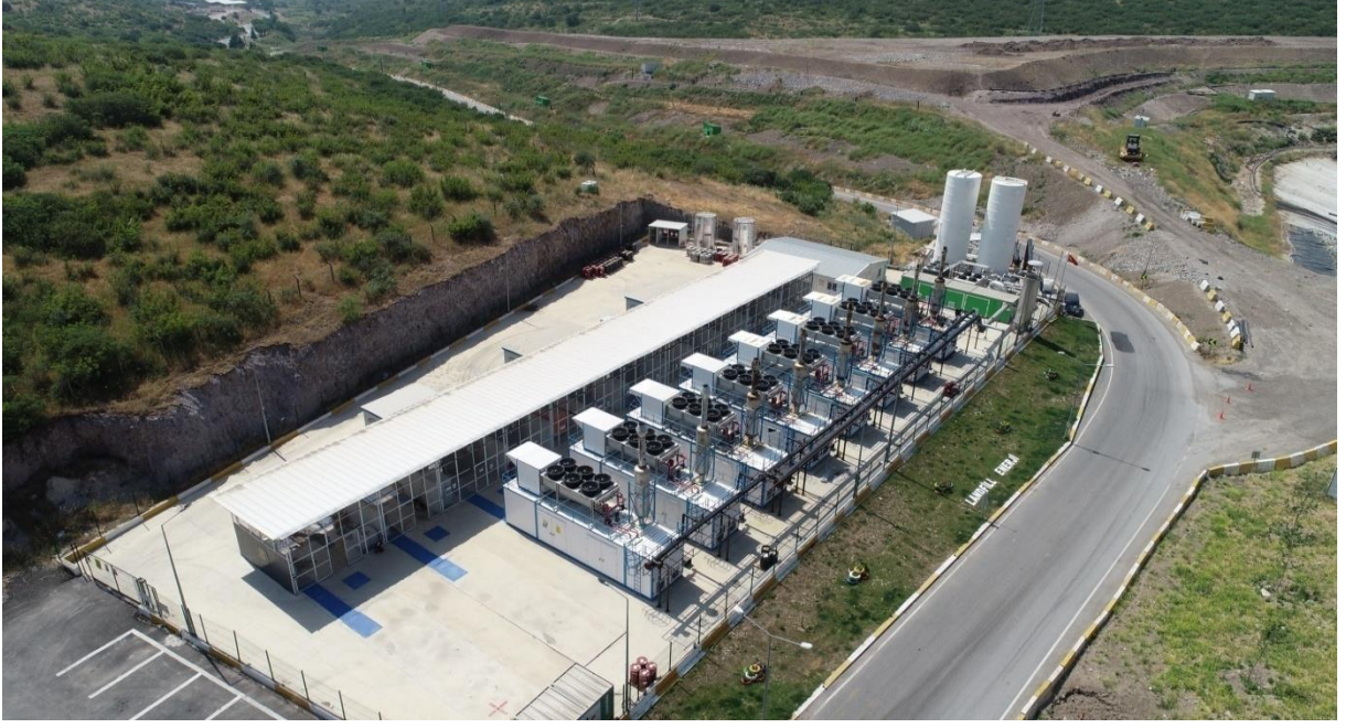
Enerji Üretim Tesisi
