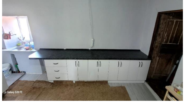
Sındırgı Karakaya Mahallesi, İhtiyaç Sahibi Vatandaşımızın Mutfak Tezgahı Dolap İmalatları ve Montajları
