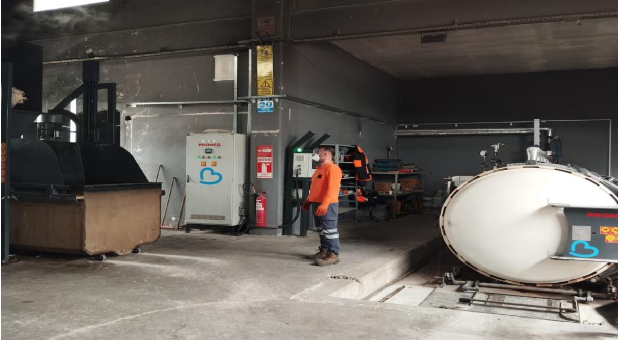
Tıbbi Atık Sterilizasyon Tesisi
