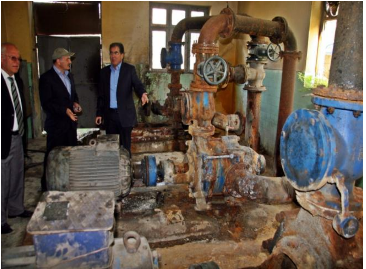
Terk edilen Numune terfi istasyonu
