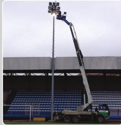
Çayırbaşı Stadı Aydınlatma Çalışması
