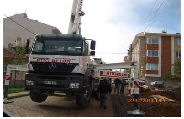
İzinsiz Beton Dökümü
