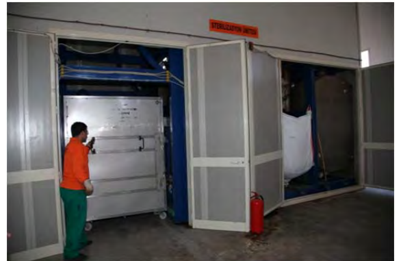
Tıbbi Atık Sterilizasyon Ünitesi
