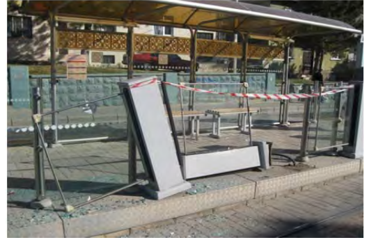
Tramvay ve Durakları Hasarı
