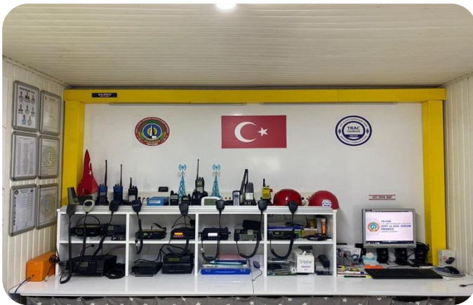
Oluşturulan Afet ve Acil Durum Haberleşme Merkezinde Kullanılan Telsiz Rölesi Sistemi
