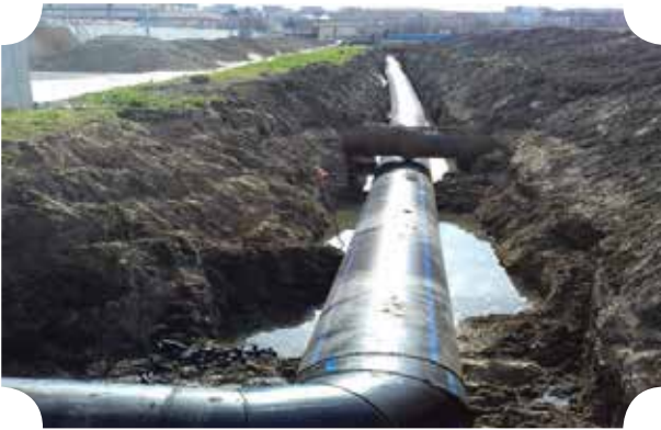
Silivri İleri Biyolojik Atık Su Arıtma Tesis Deniz Deşarjı
