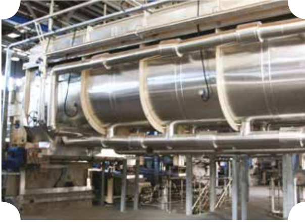
Çamur Kurutma Ünitesi
