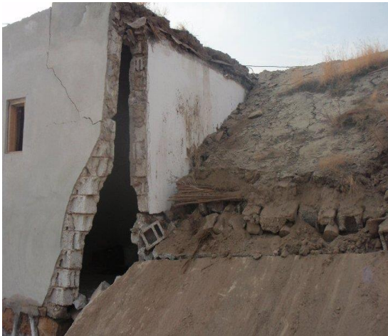
Afete Uğrayan Ev Görünümü
