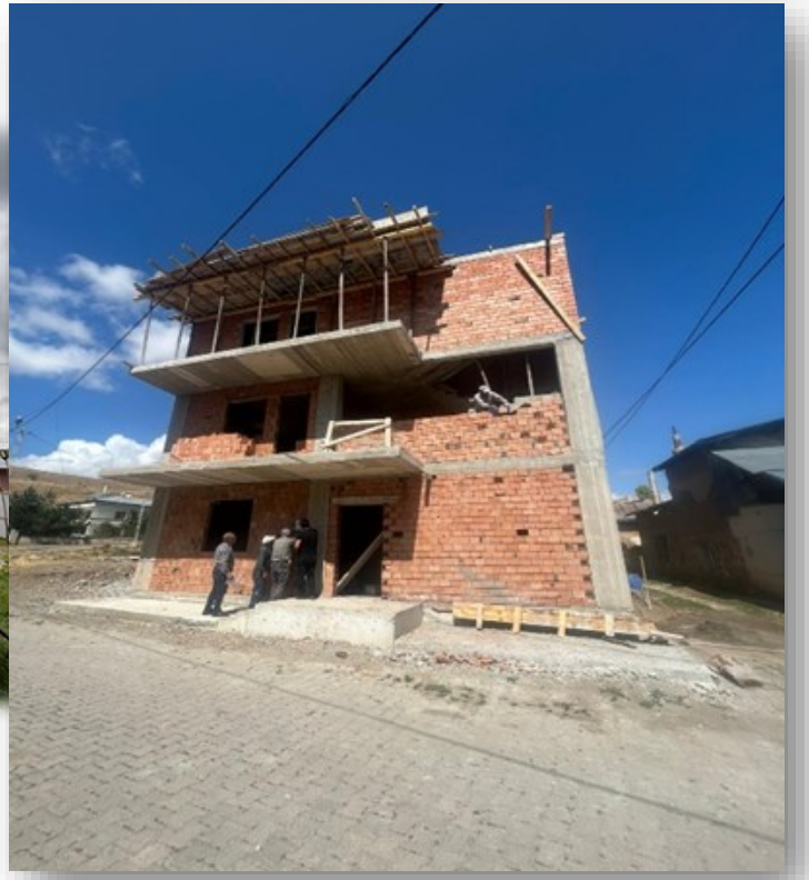
3194 Sayılı İmar Kanunu'nun 32. ve 42. Maddeleri Gereği Kaçak Yapı İşlemi Yapılan Örnek Yapılar
