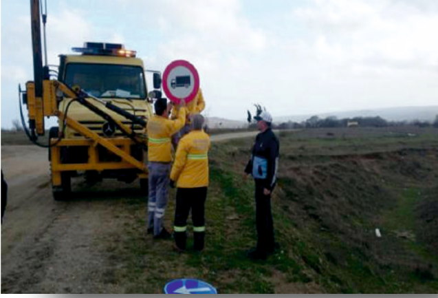
Mestanlar Mahallesi'ne "Kamyon Giremez Levhası"
