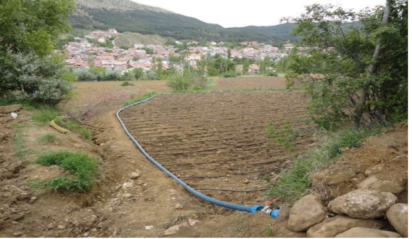
Çelikhan İlçesi Göçük Köyü Tarımsal Sulama Tesisi
