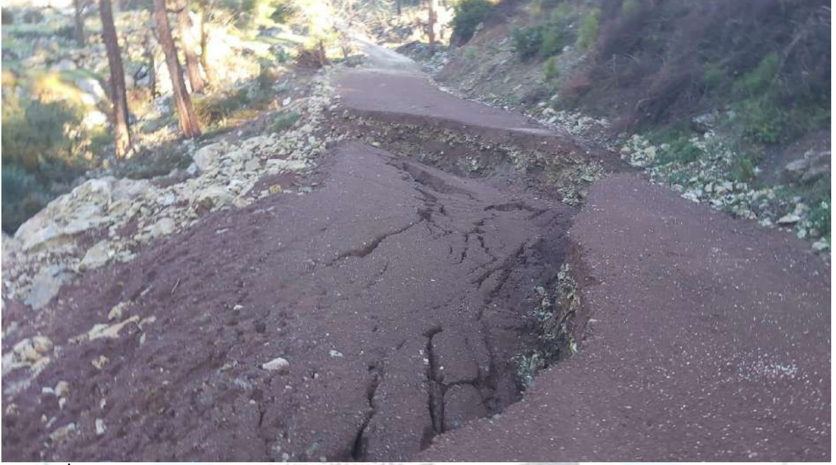
İlgi Fotoğraf: Demirciler Mahallesinde heyelan olan yolun onarılmadan önceki hali.
