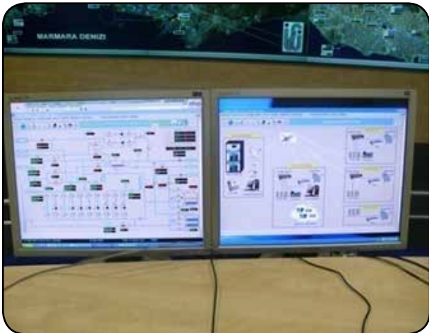
SCADA Sistemi Yeni Kontrol Merkezi
