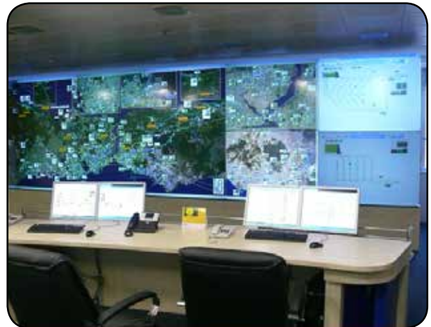
SCADA Merkezi Kontrol Ekranı ve Operatör Ekranları
