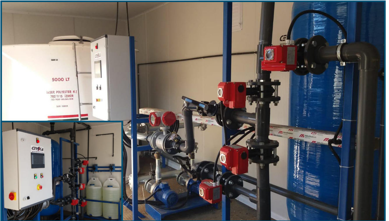
Köprübaşı Yeşilköy Mahallesi İçme Suyu Arıtma Tesisi
