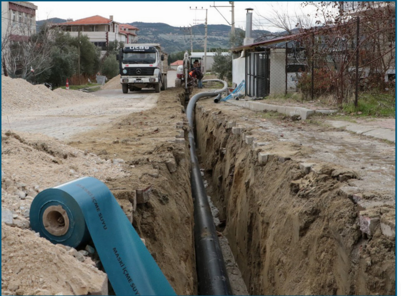
Selendi Merkez İçme Suyu Hattı
