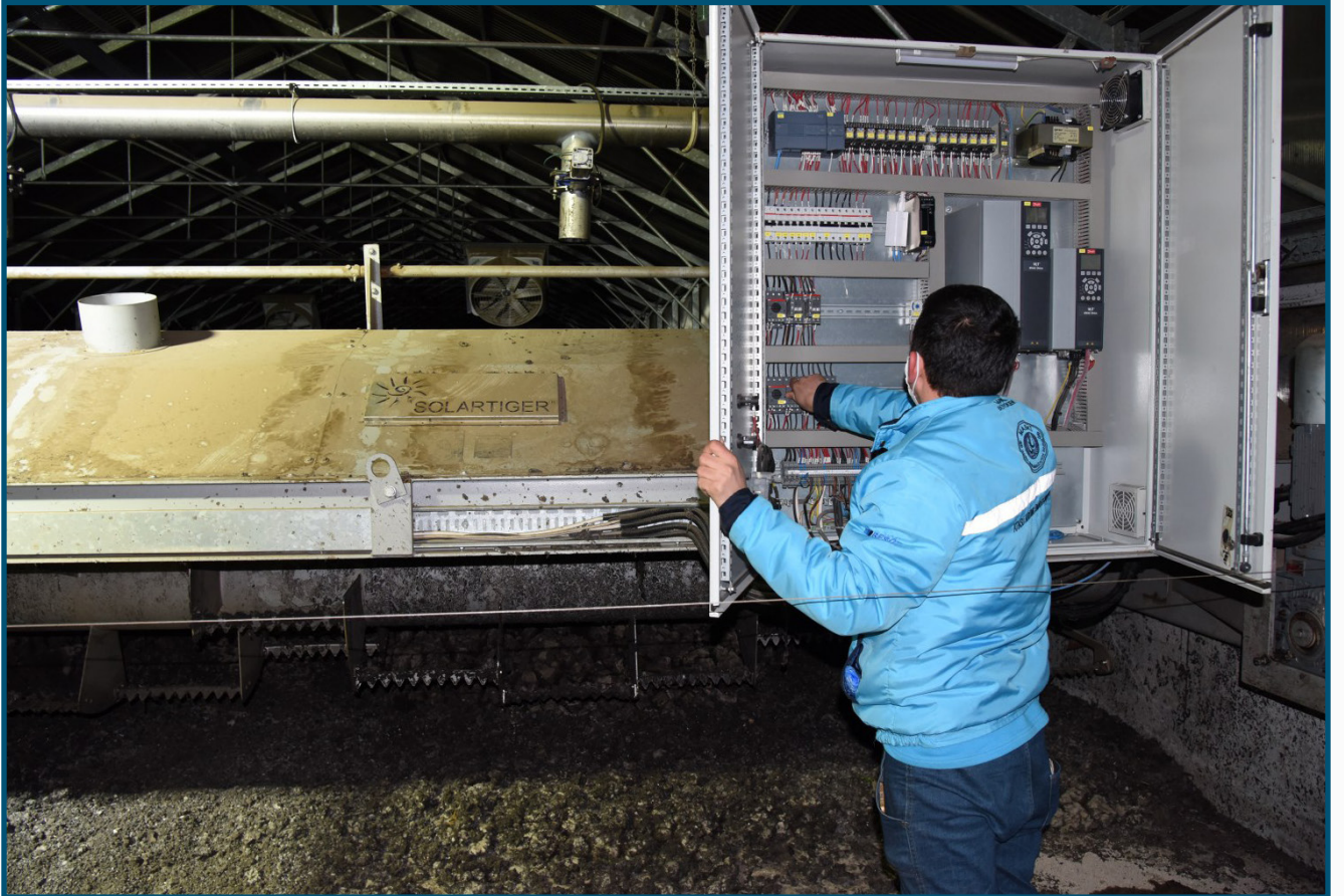
Manisa Merkez Atıksu Arıtma Tesisi Solar Çamur Kurutma Ünitesi
