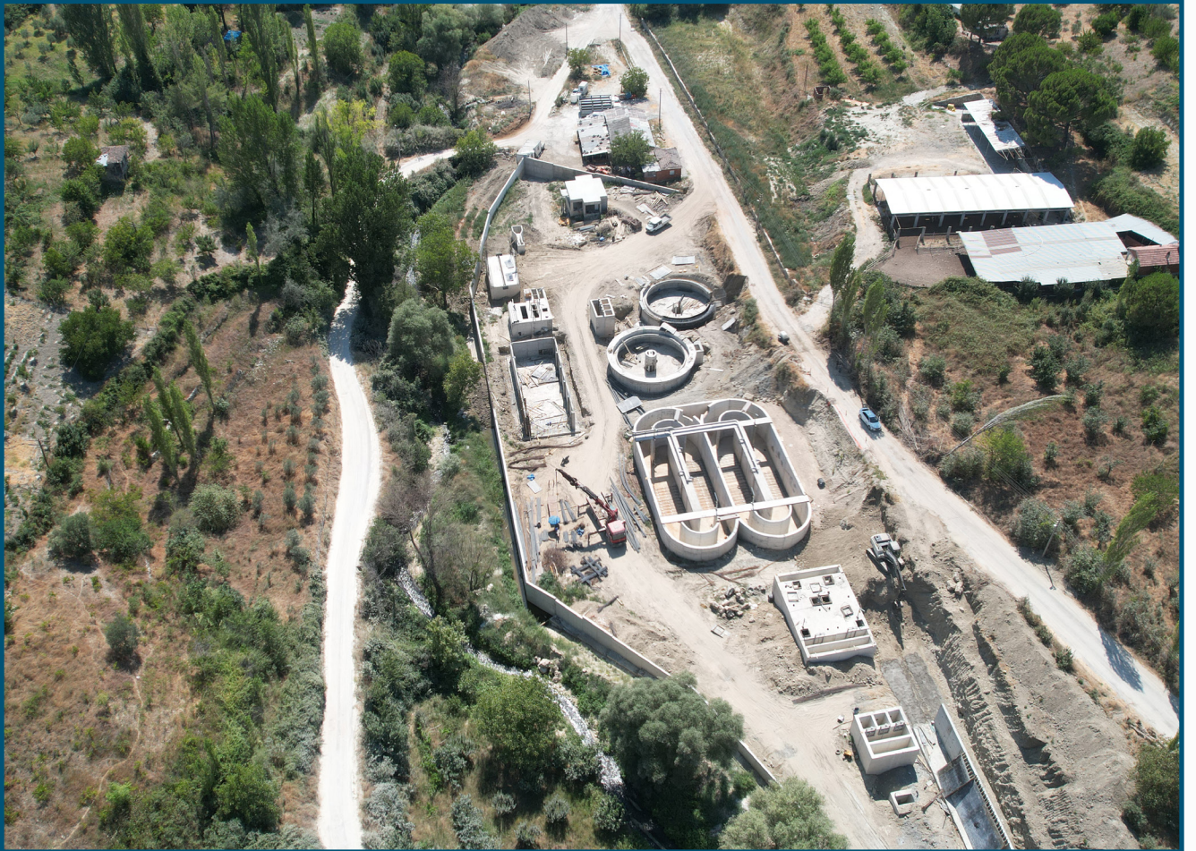
Demirci Atıksu Arıtma Tesisi
