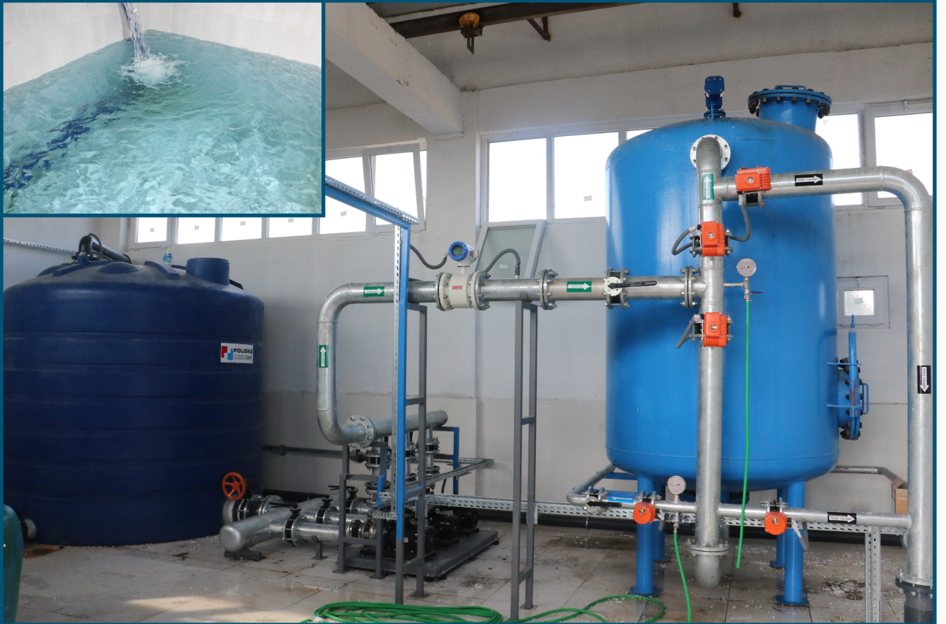
Saruhanlı İshakçelebi Mahallesi İçme Suyu Arıtma Tesisi
