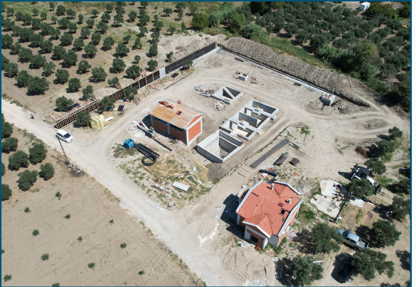
Kırkağaç İlyaslar Atıksu Arıtma Tesisi
