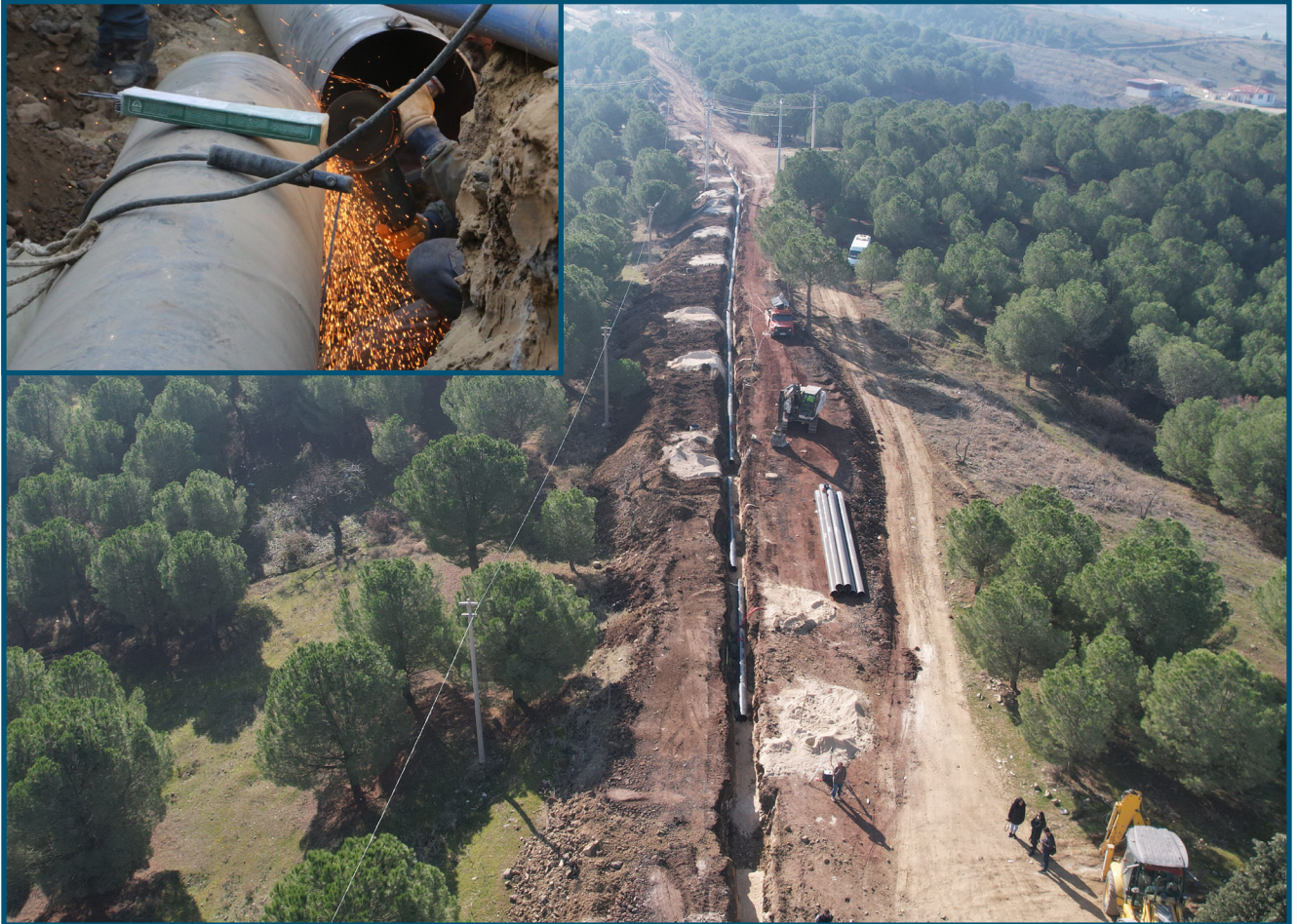
Kula Çelik İçme Suyu Terfi Hattı
