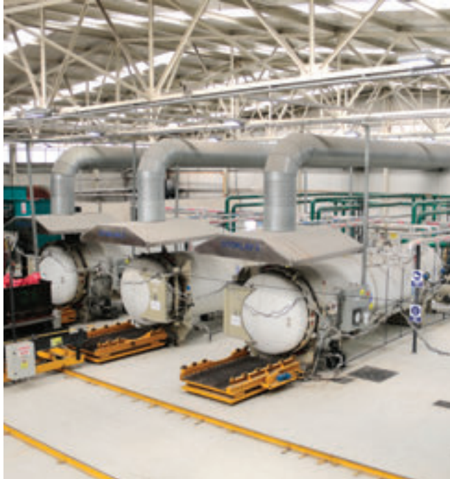
Tıbbi Atık Sterilizasyon Tesisi, Otoklav Üniteleri, Kemerburgaz, Eyüpsultan
