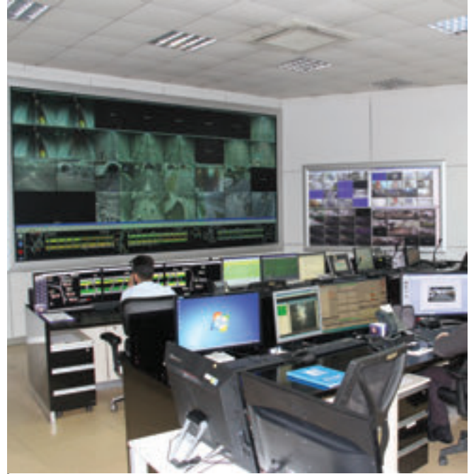
Tünel İşletim Merkezi, Şişli
