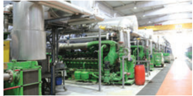
Çöp Gazından Enerji Üretim Tesis, Gaz Motorları, Eyüpsultan
