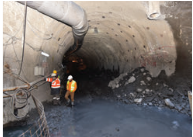
Sarıgazi İstasyonu, Çekmeköy-Sultanbeyli Metro Hattı ile Hastane-Yenidoğan Metro Hattı
