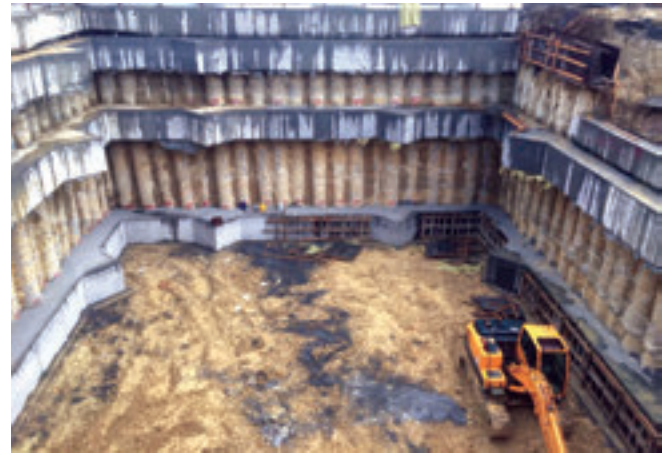
Bağcılar (Kirazlı)-Küçükçekmece (Halkalı) Metro Hattı
