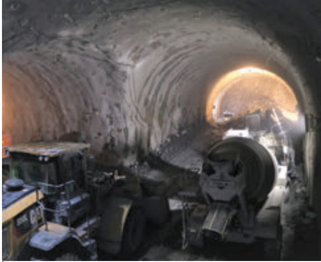
Sahrayı Cedid İstasyonu, Ümraniye-Ataşehir-Göztepe Metro Hattı
