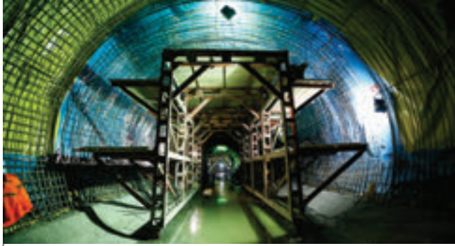
Nurtepe İstasyonu, Kabataş-Mecidiyeköy-Mahmutbey Metro Hattı
