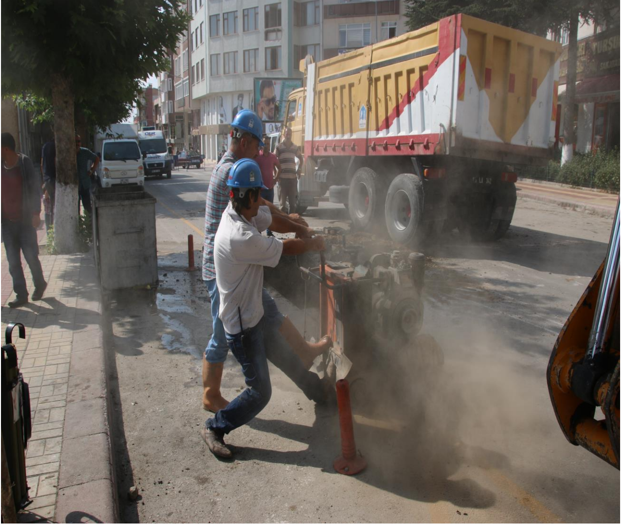
( Cumhuriyet Caddesi Su Patlađı ve Asbest Boru Deđiřimi )
