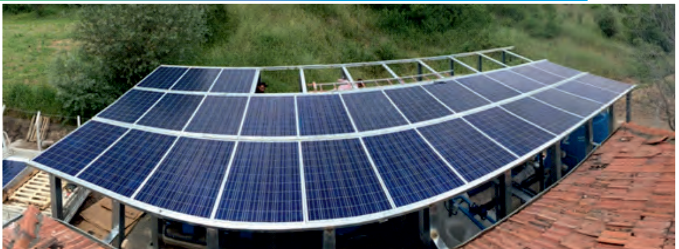
İçme Suyu - Güneş Enerji Sistemi
