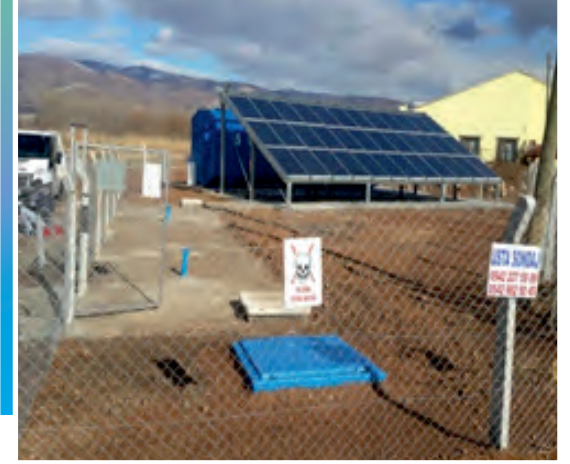
Paket arıtma enerji Üretim sistemi çalışması
