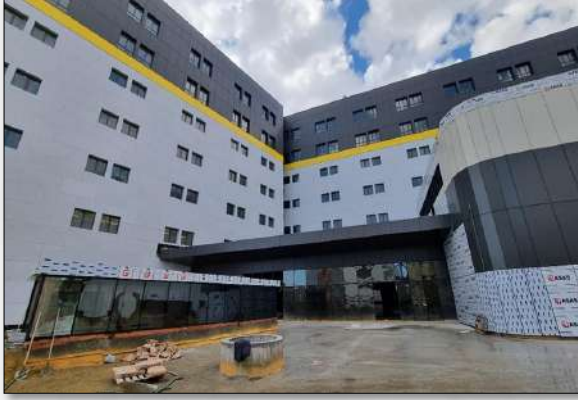
Resim 287. Avcılar Yerleşkesi Kimya Bölümü, Kimya Müh. Ve Metalürji ve Malzeme Müh. Binası Yapılması İşi
