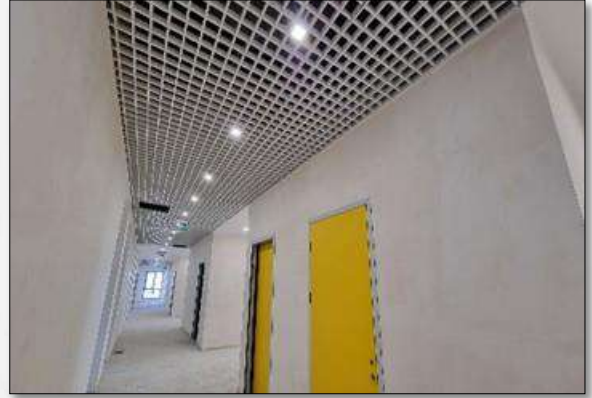
Resim 290. Avcılar Yerleşkesi Kimya Bölümü, Kimya Müh. Ve Metalürji ve Malzeme Müh. Binası Yapılması İşi
