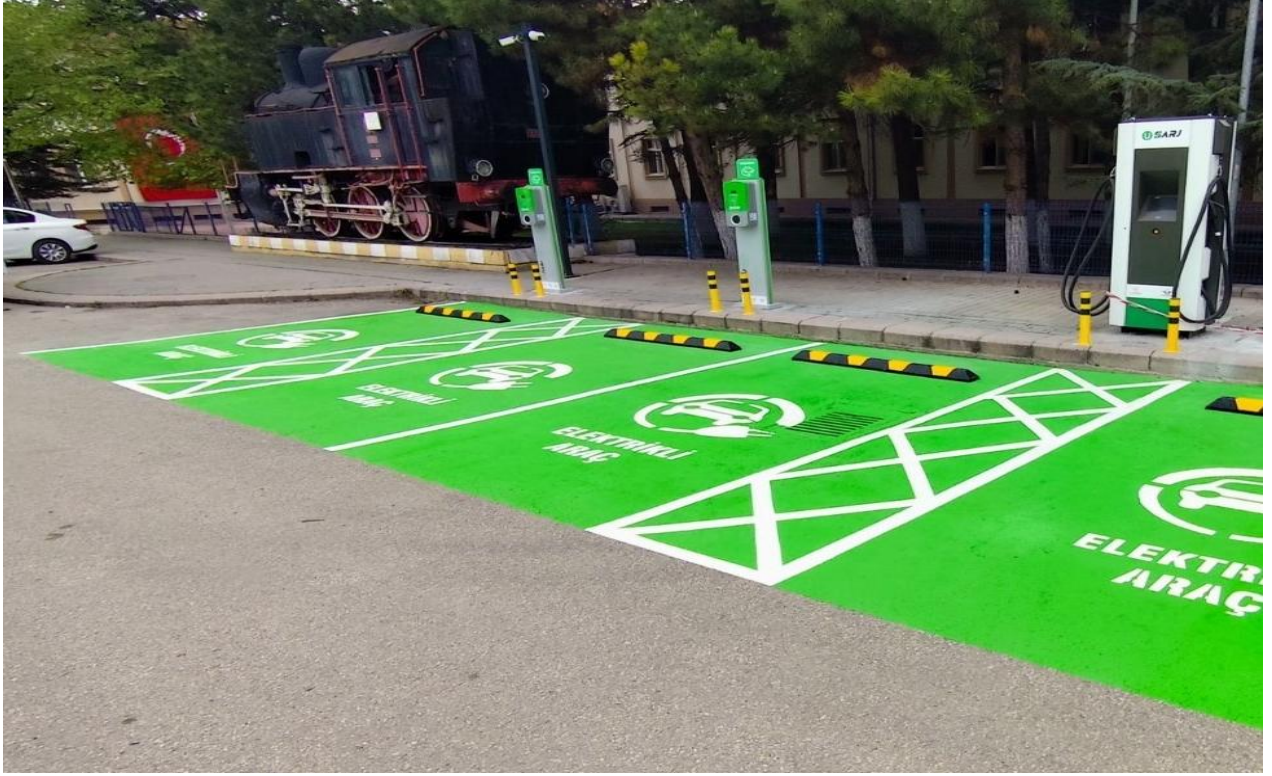
Eskişehir Gar Elektrikli Şarj İstasyonu
