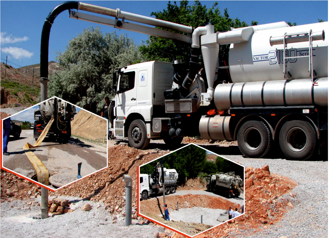
Küçükmuhsine Köyü Atıksu Nakli
