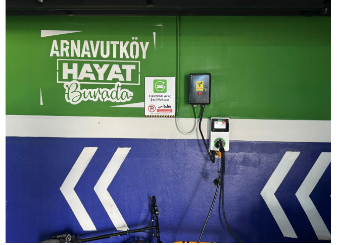
Arnavutköy Meclis Otoparkı Elektrikli Araç Şarj İstasyonu, 2024
