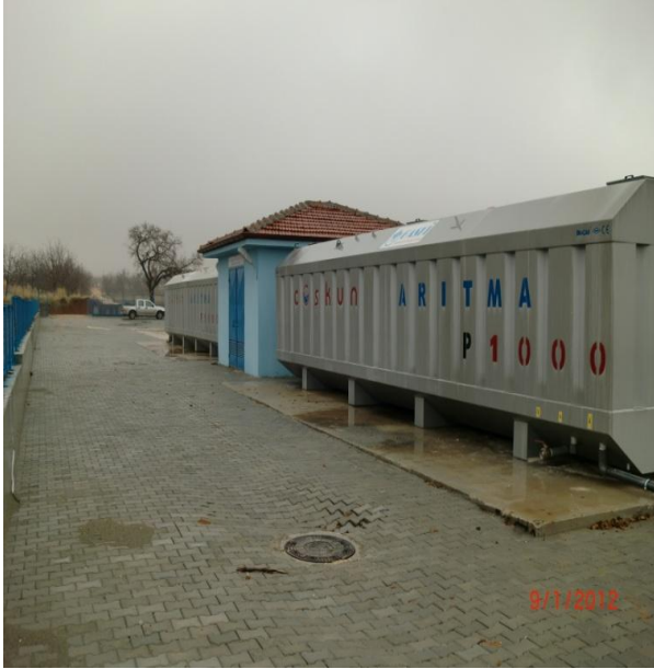
Akçaburç Paket Arıtma Tesisi
