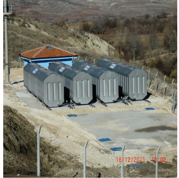
Burç Beldesi Paket Arıtma Tesisi
