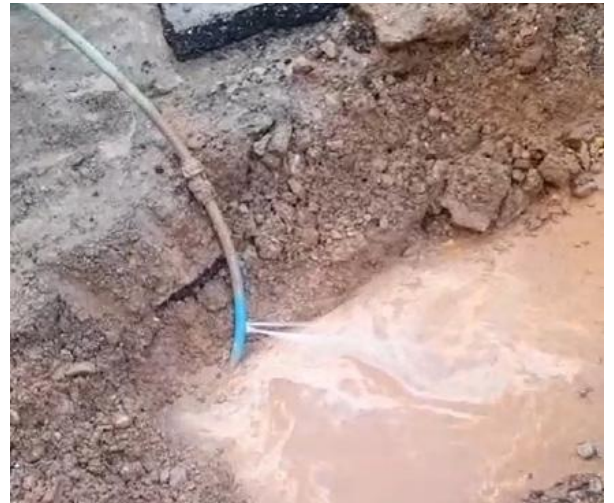
Muratpaşa İlçesi, Muratpaşa Mahallesi, Çatalköprü Caddesi, Ø25 HDPE abone borusu arıza tespiti.
