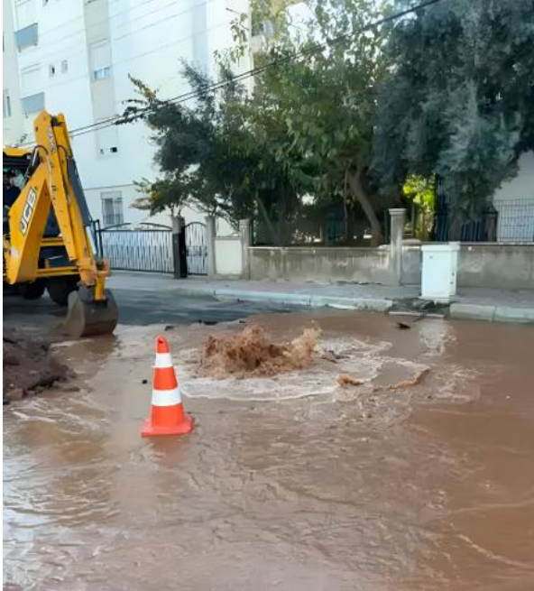
Kepez İlçesi, Şelale Mahallesi, Ø110 HDPE arıza tespiti
