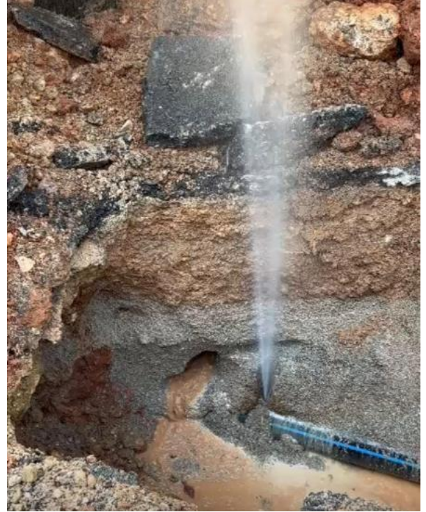
Kepez İlçesi, Özgürlük Mahallesi Mithat Paşa Cad. Ø160mm HDPE arıza tespiti.
