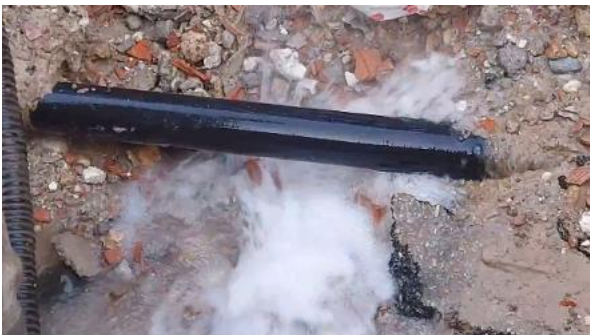
Muratpaşa İlçesi, Demircikara Mahallesi 1429. Sokak Ø90mm PVC arıza tespiti.
