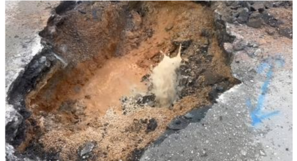
Kepez İlçesi, Güvenlik Mahallesi 270. Sokak Ø125 HDPE arıza tespiti.
