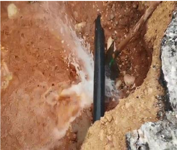
Kepez İlçesi, Yenidoğan Mahallesi Ø110'luk HDPE yarık arıza tespiti.
