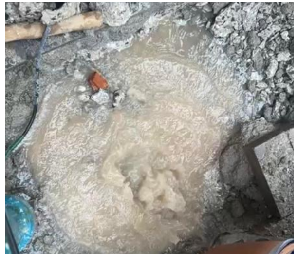
Şekil 29. Muratpaşa İlçesi, Selçuk Mahallesi, Mektep Sokak, Ø110 HDPE arıza tespiti.
