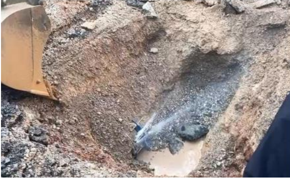
Muratpaşa İlçesi, Yenigün Mahallesi, 1055. Sokak Ø400 AÇB arıza tespiti.
