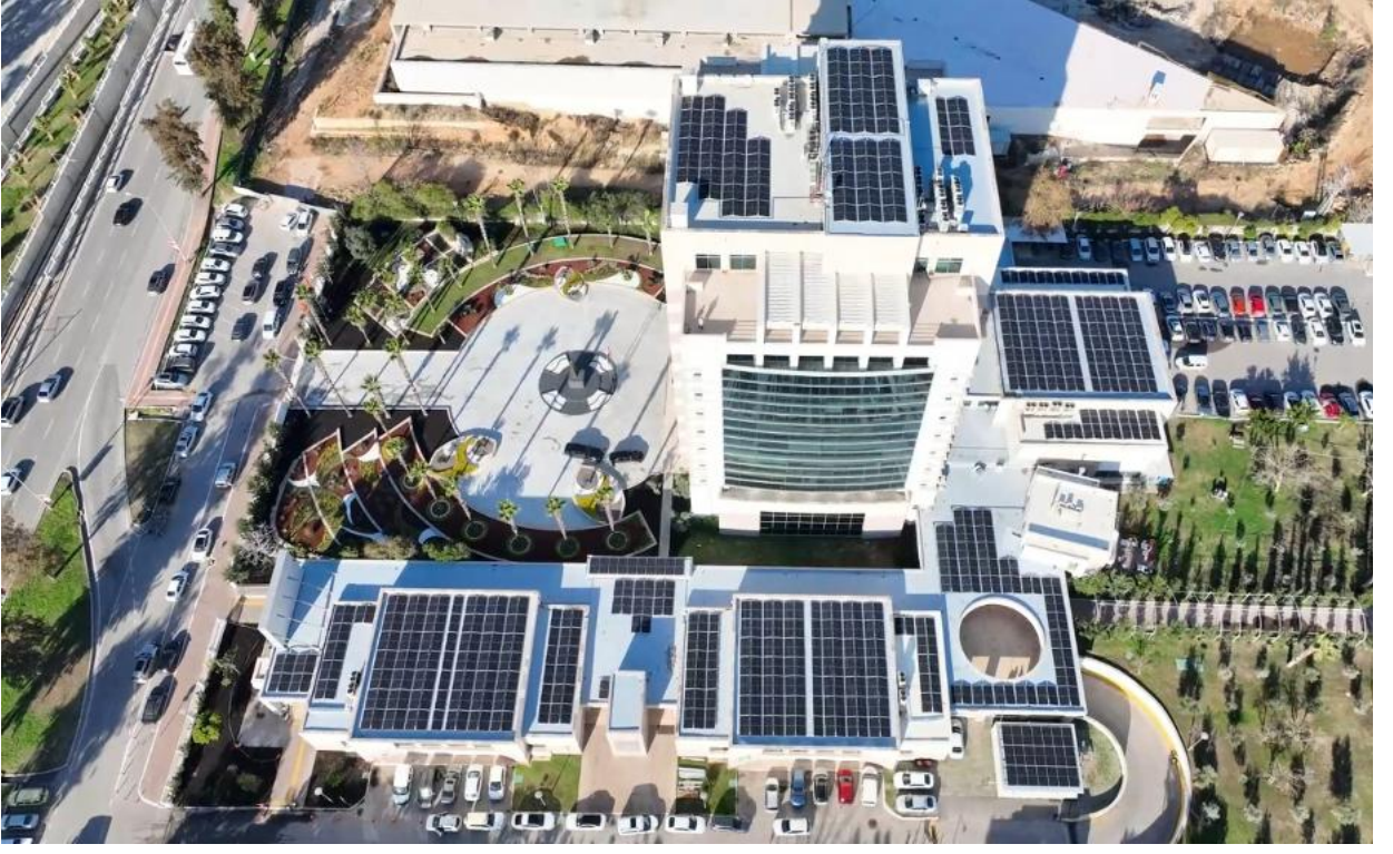
ASAT Genel Müdürlüğü Çatı GES (0,341 MWp)
