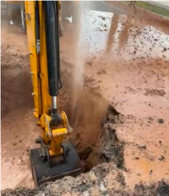
Kepez İlçesi, Aydoğmuş Mahallesi Fatih Terim Cad. Ø225mm HDPE arıza tespiti.
