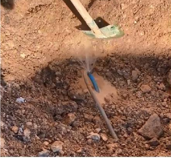
Kepez İlçesi, Altınova Sinan Mahallesi 39. Sokak Ø25mm HDPE abone borusu arıza tespiti
