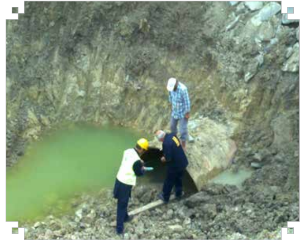
Esenyurt Atık su Çelik Borunun Katodik Koruma TR Ünitesi ve Akım İhtiyaç Test Çalışması
