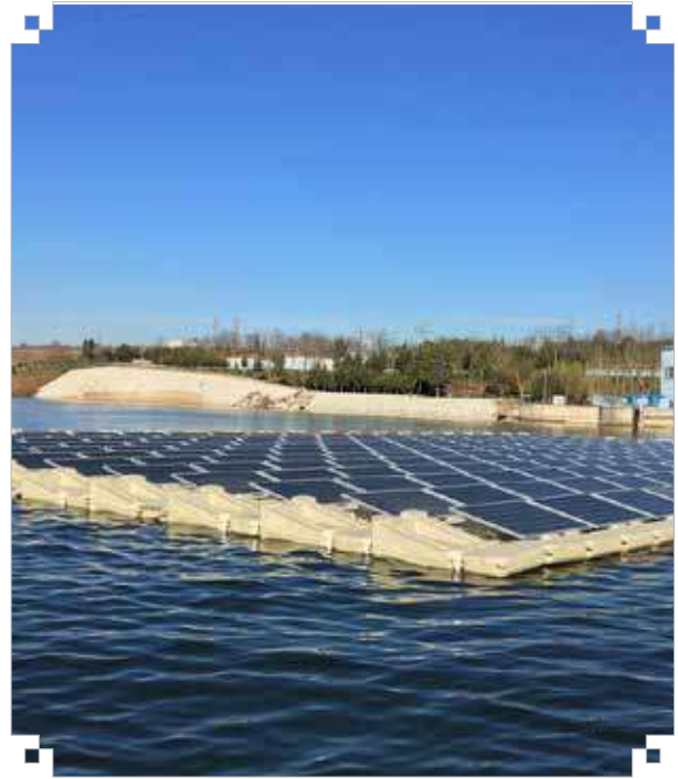
Yüzer Güneş Enerji Panelleri
