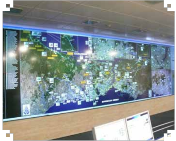
SCADA Merkezi Kontrol Ekranı ve Operatör Ekranları
