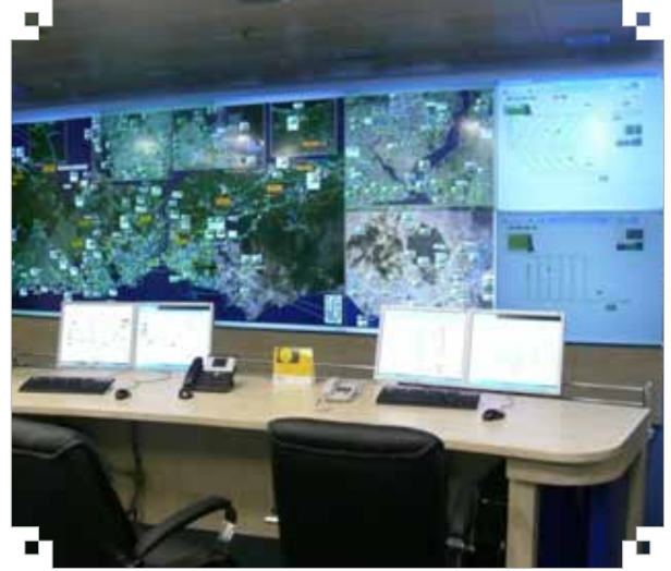
SCADA Kontrol Merkezi Ana Ekranı
