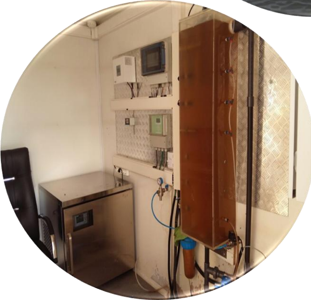
Atıksu Arıtma Tesisi Uzaktan İzleme Sistemi
