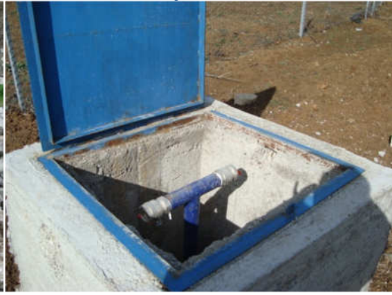
)(İçme suyu vana kontrolü)
