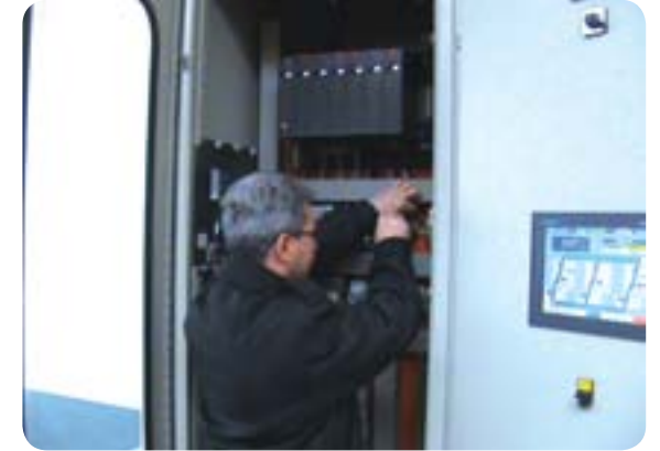
Pompa istasyonu RTU Panosu
