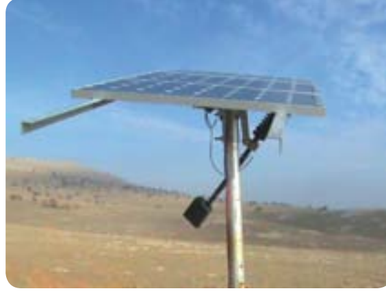
Tesislerimizde kullanılan güneş panelleri
