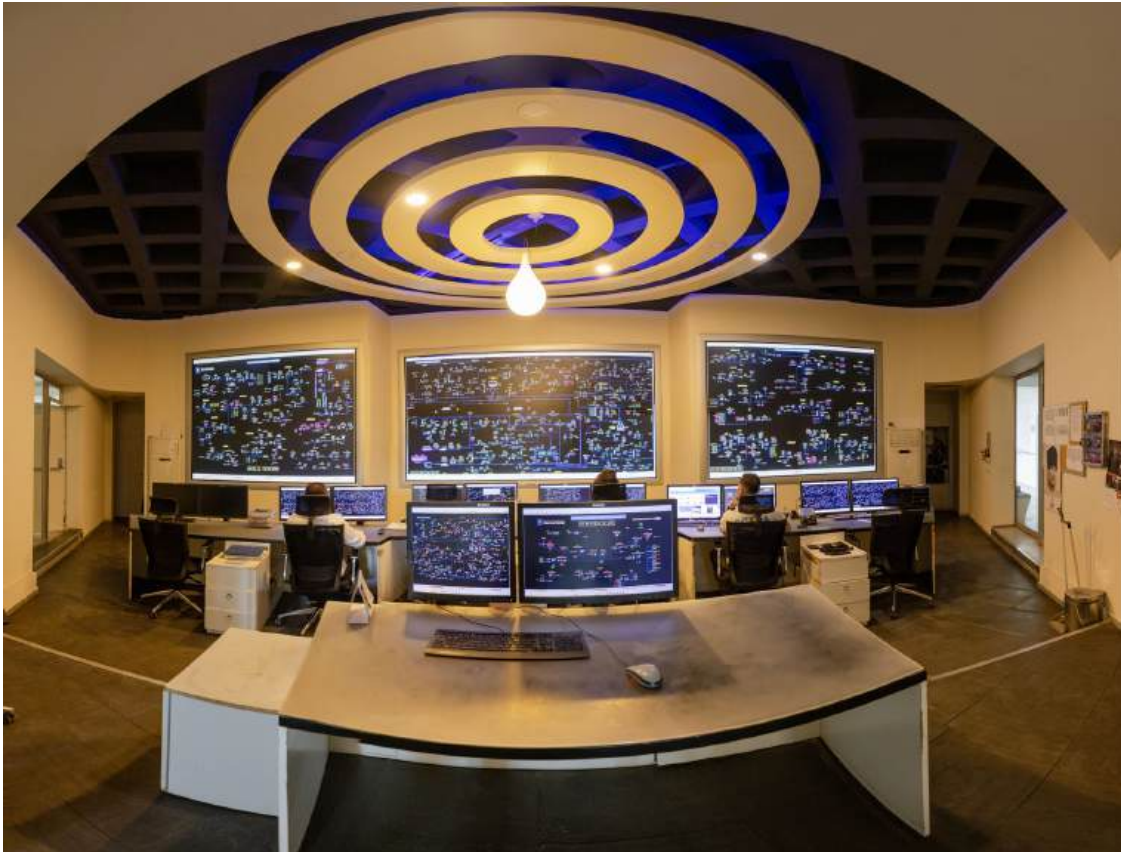
Halkapınar SCADA Merkezi
