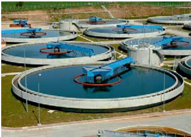
Çatalan İçmesuyu Arıtma Tesisleri
