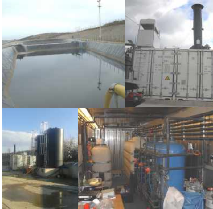
Resim : Sızıntı Suyu Arıtma Tesisi
