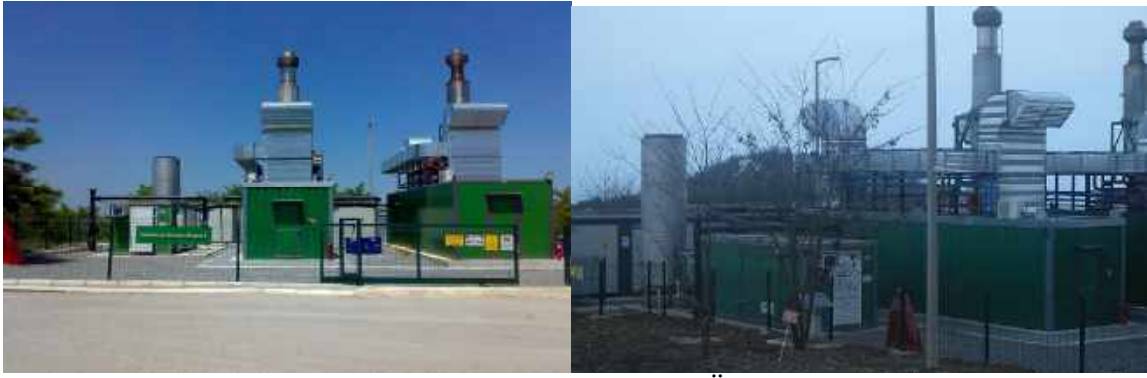
Resim: Metan Gazından Elektrik Üretim Tesisi
