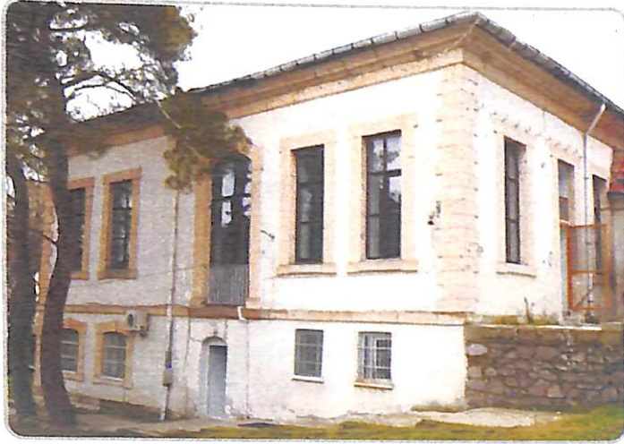
Merkez Göğüs Hastalıkları Hastanesi Arka Girişi Restorasyon Öncesi Hali
