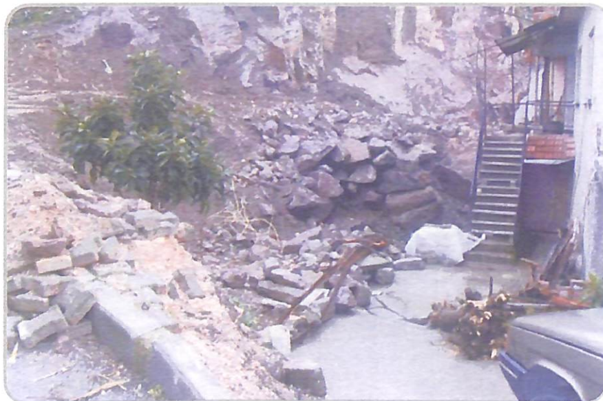
Kızpınar Mahallesinde Yol Kayması Kaldırma Çalışmaları
