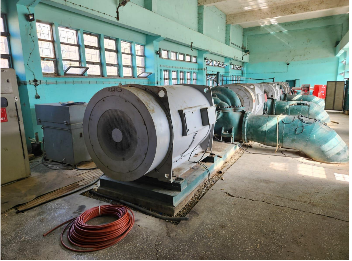
P2 Pompa İstasyonu Motorların içerden görüntüsü
