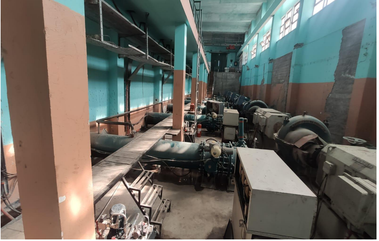
P1 Pompa İstasyonu Motorların içerden görüntüsü
