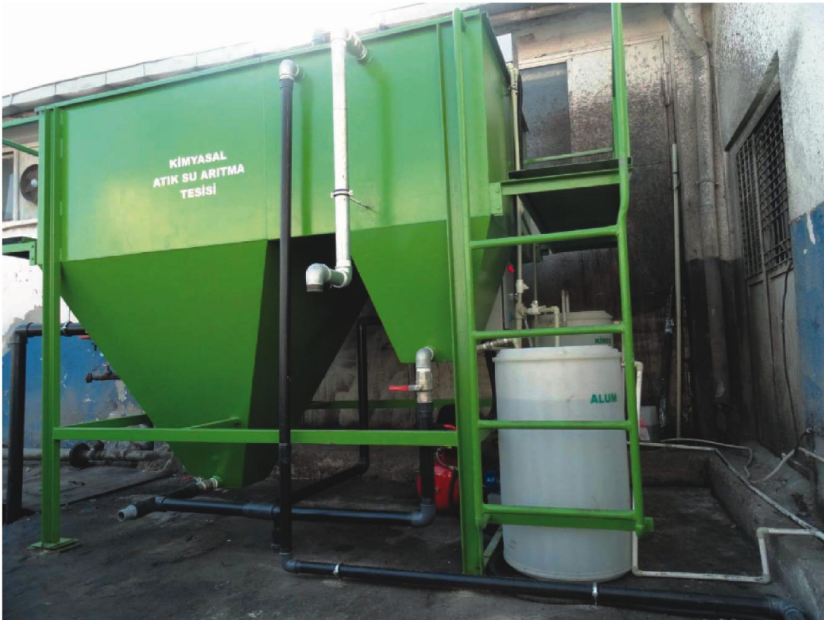
Şekil 20. Denetimi Yapılan Firmaya Yaptırılan Endüstriyel Atıksu Arıtma Tesisleri Görüntüsü
