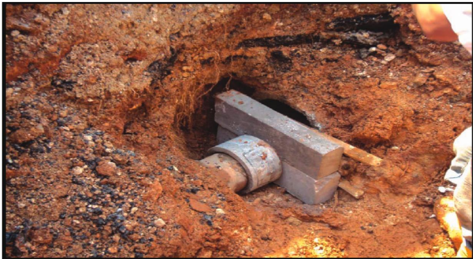
Yukarıdaki resimde Afetevler Mahallesiinde 3116 sokakta 150'lik AÇB boruda manşondaki yıpranmış conta değiştirilerek tamir yapıldı.
