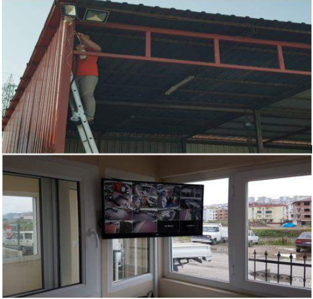
Temizlik İşleri Şantiyesi Güvenlik Kamerası Kurulum İşİ
