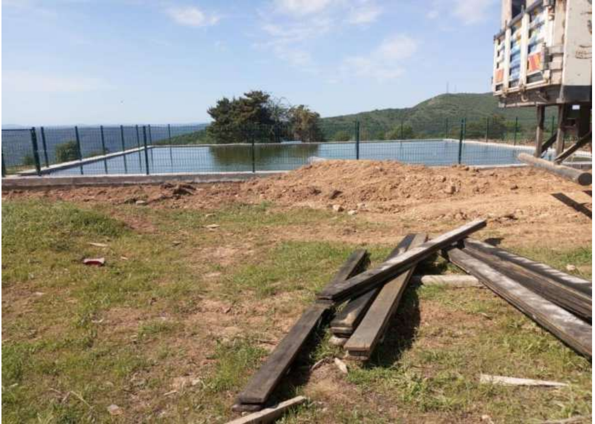
Merkez Karataş Köyü YÜS Sulama Tesisi Havuzu
