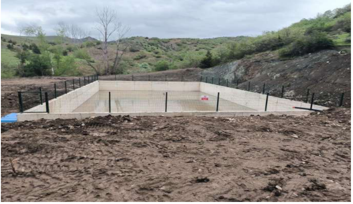
Suluova Alabedir Köyü Sulama Tesisi Havuzu
