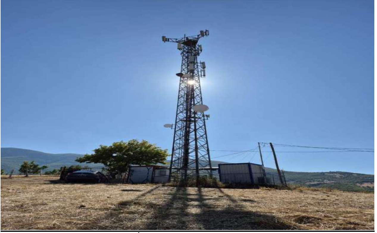
Esençay'da Kirada Bulunan Baz İstasyonu
