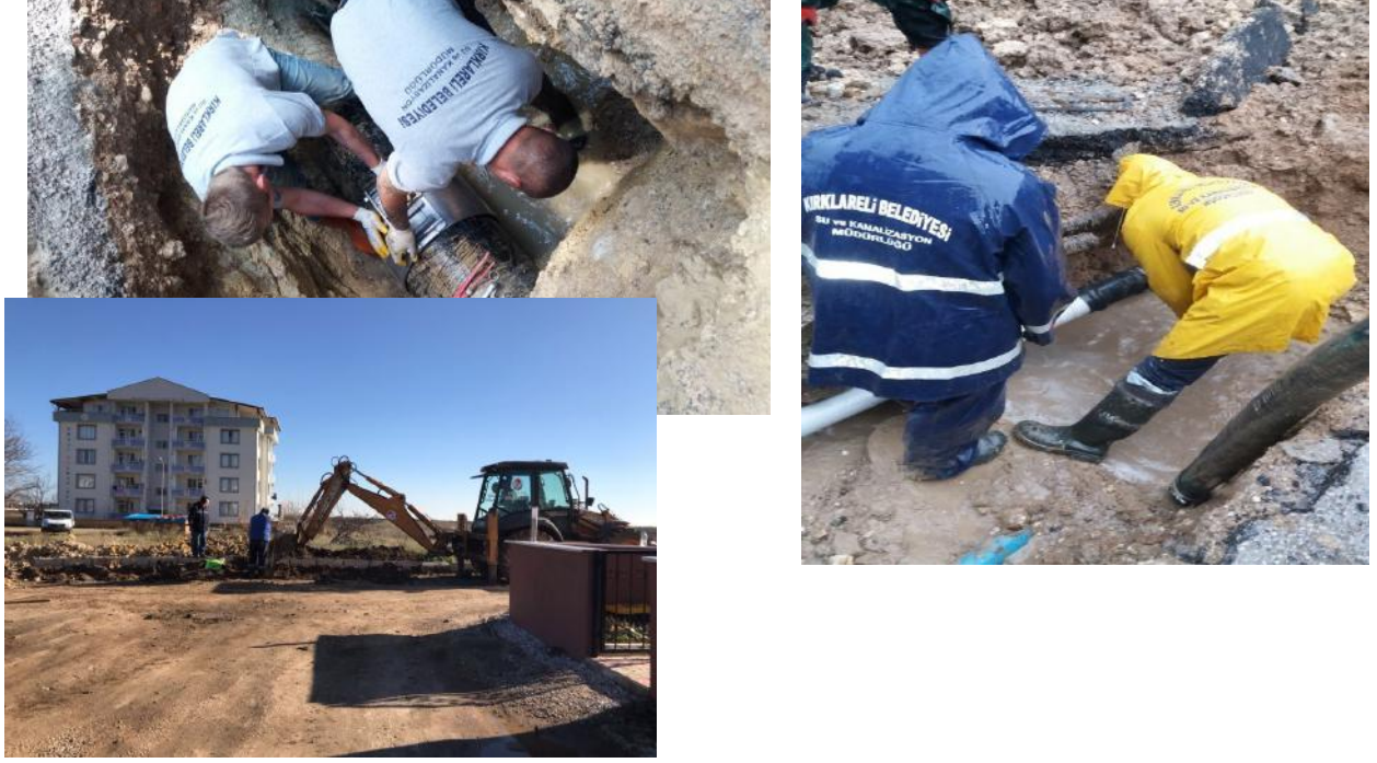
Resim 10-11 Yayla Mahallesi Kanal Abone Bağlantıları
