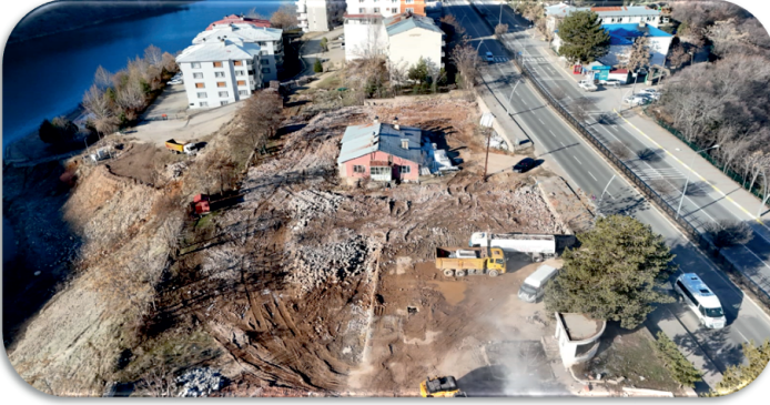
Deprem Performans Analizi Sonucu Yıkımına Karar Verilen Lojmanlar
