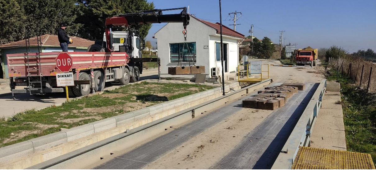
Asfaltlama ve Konkasör Tesisi 80 tonluk Tır Kamyon Giriş Kantar
