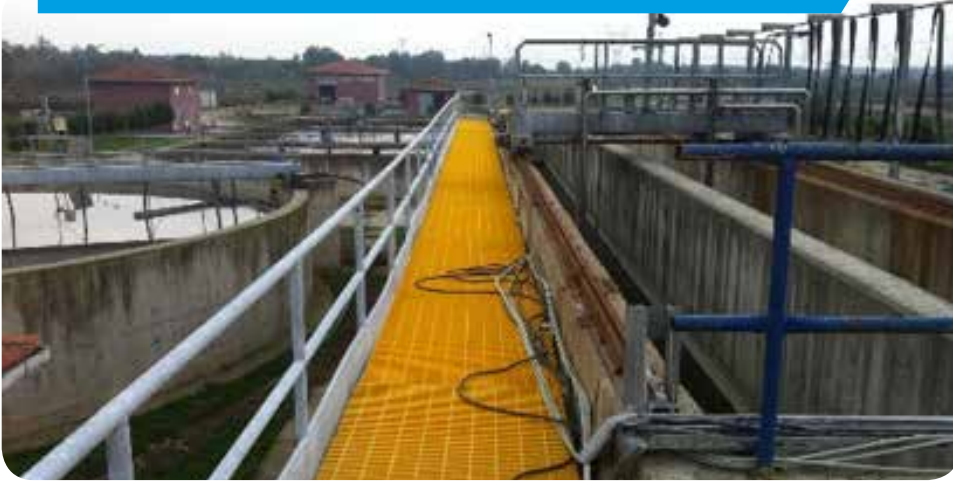
Hendek Atıksu Arıtma Tesisi Kum Tutucu Havuzu Yürüyüş Platformu
