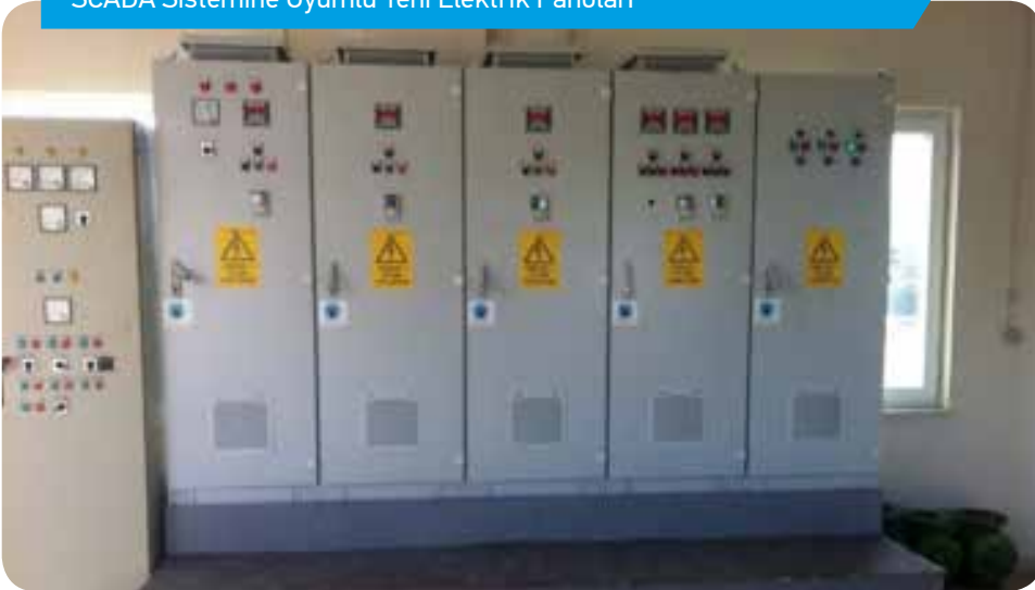
SCADA Sistemine Uyumlu Yeni Elektrik Panoları
