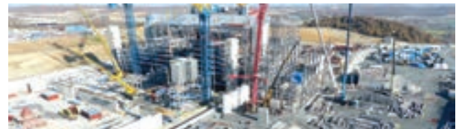
İBB Atık Yakma ve Enerji Üretim Tesisi, Eyüpsultan
