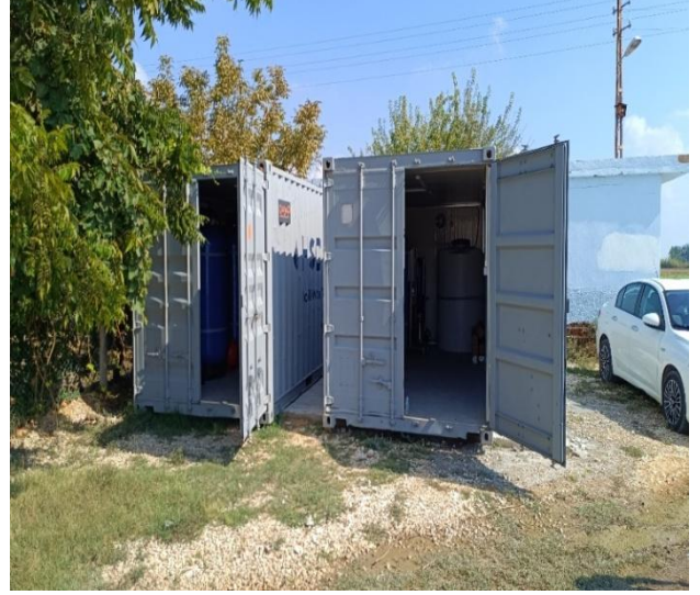
Tarsus Baltalı Paket İçme Suyu Arıtma Tesisi
