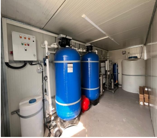
Tarsus Baltalı Paket İçme Suyu Arıtma Tesisi Sistemi
