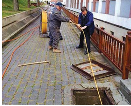
Bölge Müdürlüklerindeki binaların birbirine fiber optik kablo ile irtibatlandırılması
