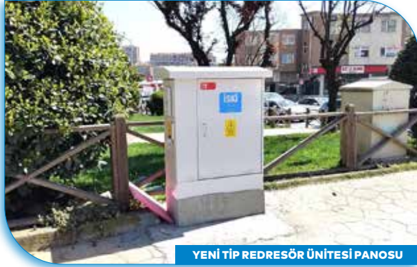
YENİ TİP REDRESÖR ÜNİTESİ PANOSU
