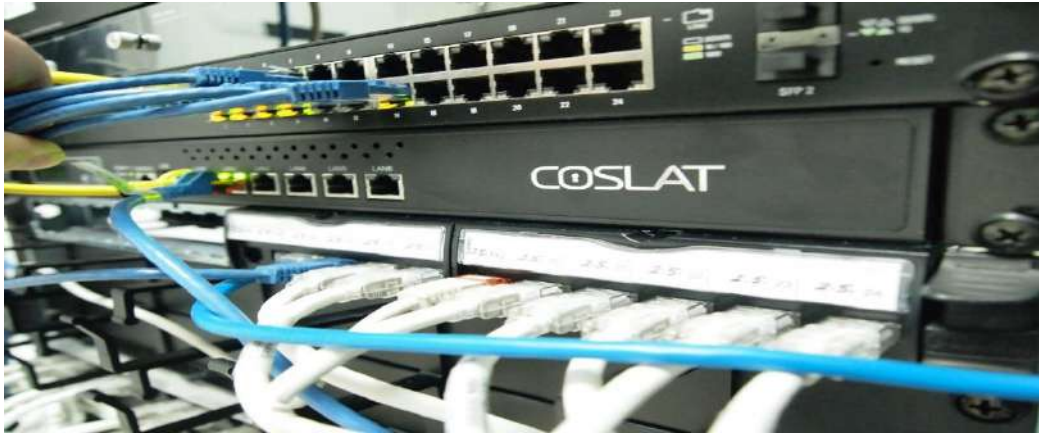
Kablosuz Ağ Kablolama
