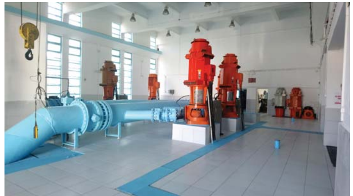
Porsuk İçmesuyu Tesisinde Çalışan Pompalarımızın Görüntüsü
