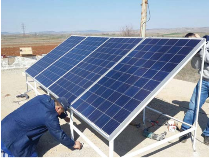
Yoncalı İçmesuyu Deposuna Kurulan Güneş Enerji Panelleri
