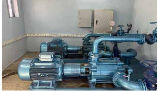
(Saatçi Abdi İçme suyu Tesisi )
