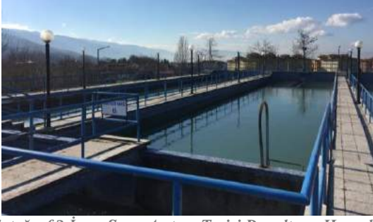
Fotoğraf 3 İçme Suyu Arıtma Tesisi Durultucu Havuzlar
