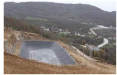
Fotoğraf 11 Sızıntı Suyu Dengeleme Havuzu
