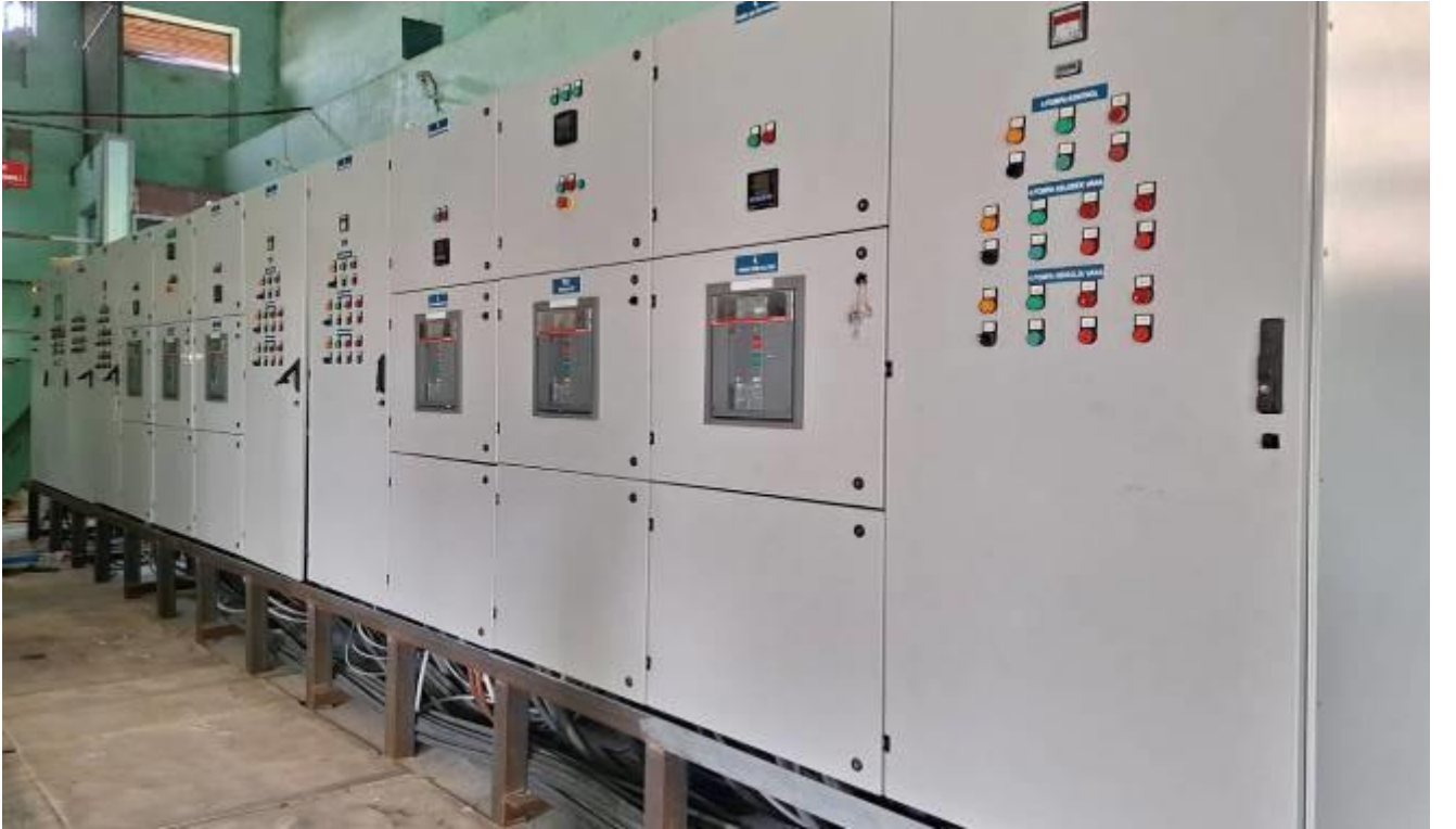
P1 Pompa İstasyonu Motorların içerden görüntüsü
