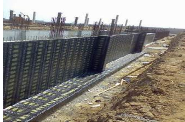
Perde Su Yalıtımı
