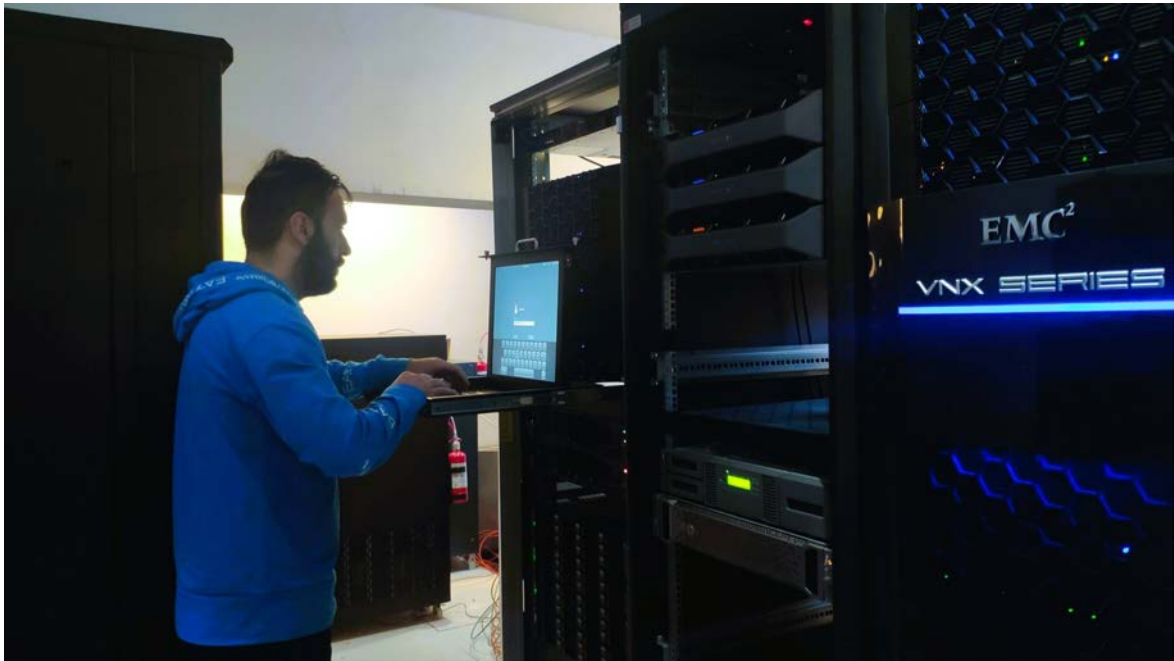
Kapasitesi artırılan TÜYEK Sistem Odası – Süleymaniye Külliyesi
